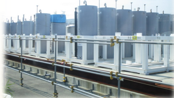
新しい汚染水保管タンク
